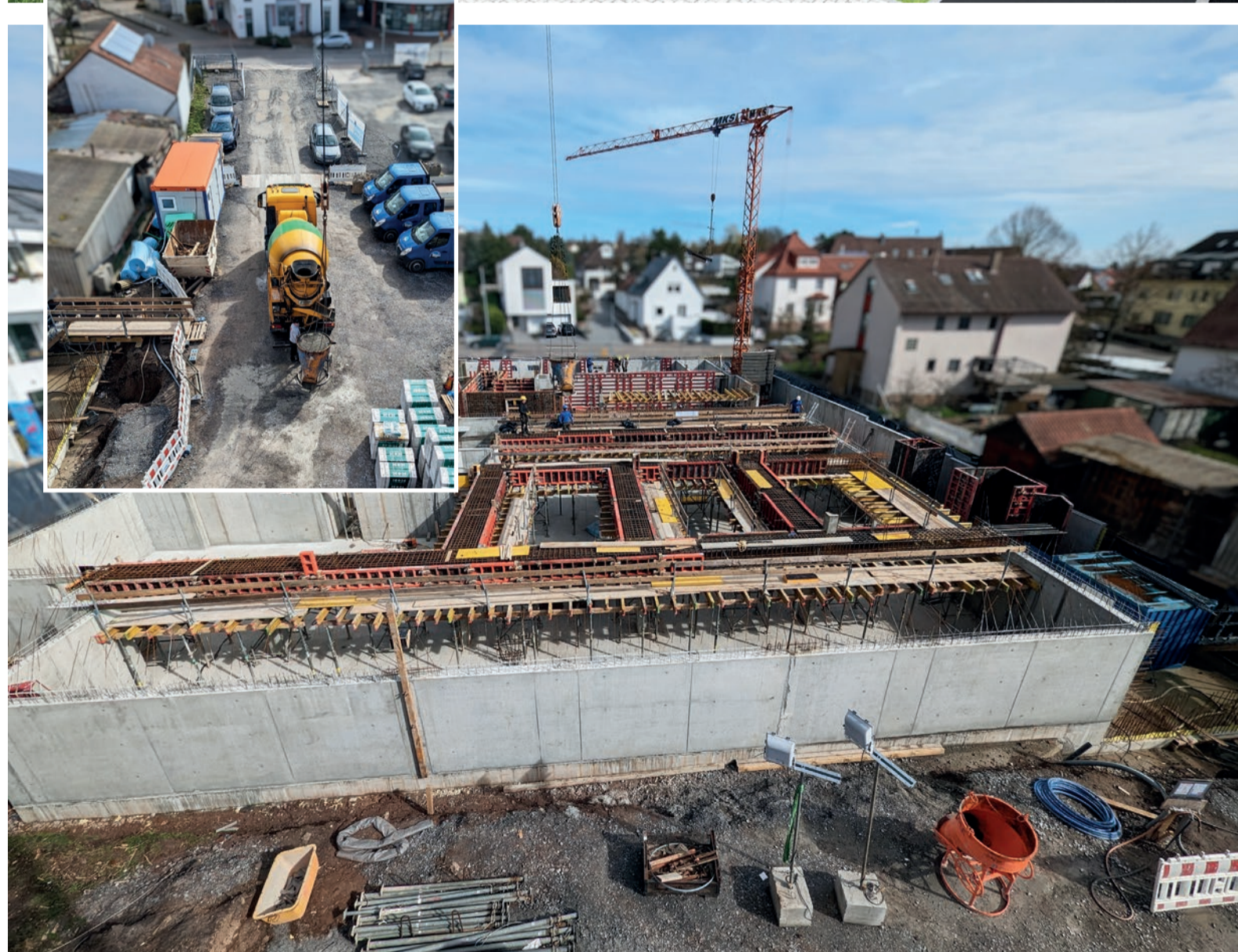
Oben: Animation des Mehrfamilienhauses in Brackenheim: eine Wohnanlage mit Tiefgarage und grünem Innenhof. Darunter: Die Baustelle, fotografiert vom außenstehenden Kran. Das Untergeschoss im Rohbau ist bereits fertiggestellt. Mitte: Zulieferverkehr und Gewerkeparkplatz auf engen Raumverhältnissen
