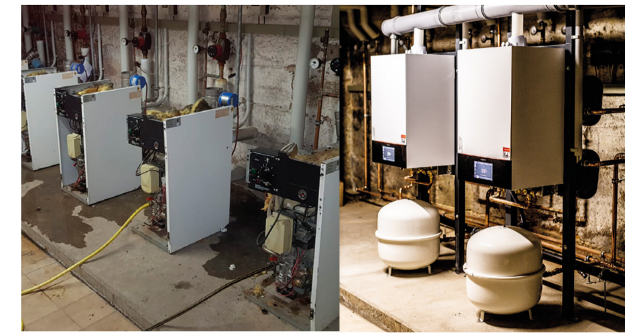
Zum Vergleich: eine alte Heizungsanlage im Bau (links) und die kompakte neue Version
